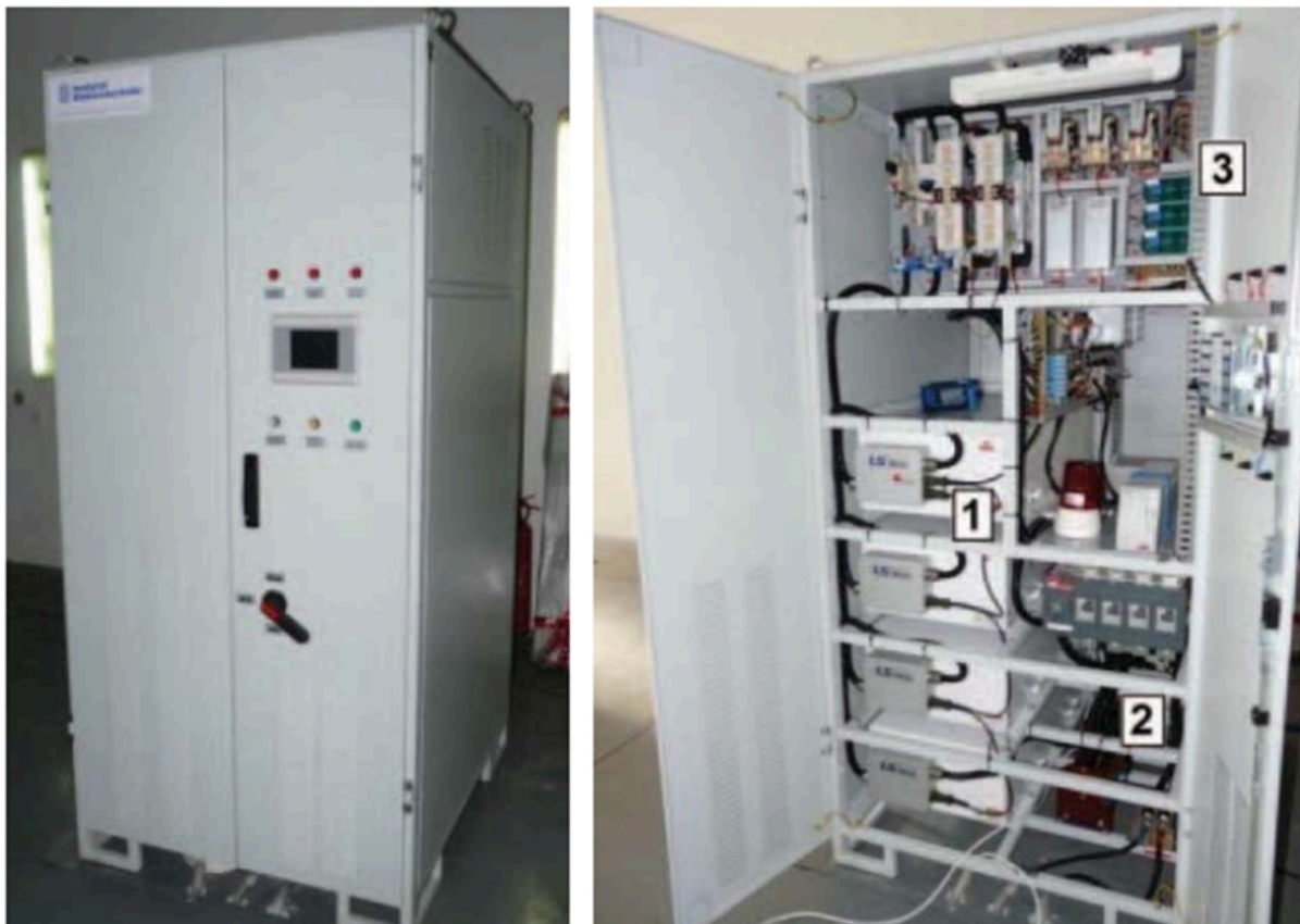
Приклад суперконденсаторного накопичувача на тяговій підстанції у Польщі. 1 – суперконденсатори сумарною ємністю 0,7 кВт·год, 2 – DC/DC перетворювач потужністю 150 кВт, 3 – пристрій захисту та фільтри.
