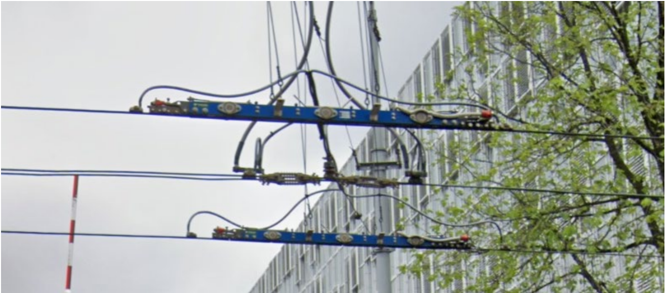
Рисунок 7. На фото з Амстердаму, Нідерланди [4], зображено секціонування контактної мережі в кінці ділянок живлення суміжних підстанцій. Окрім секційних ізоляторів контактних дротів, також видно розріз підсилюючої дводрової лінії, яка доходить до самого кінця ділянок живлення.
