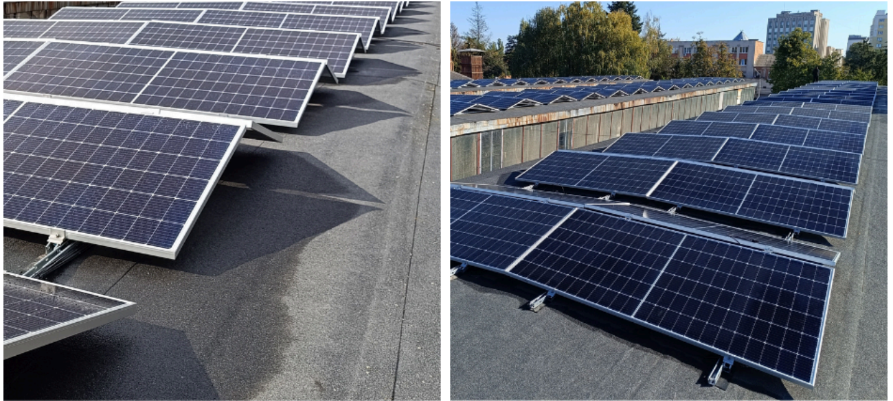
Фото: сонячна електростанція (СЕС) загальною потужністю 100 кВт на даху депо КП «Вінницька транспортна компанія», джерело: Вінницька міська рада
