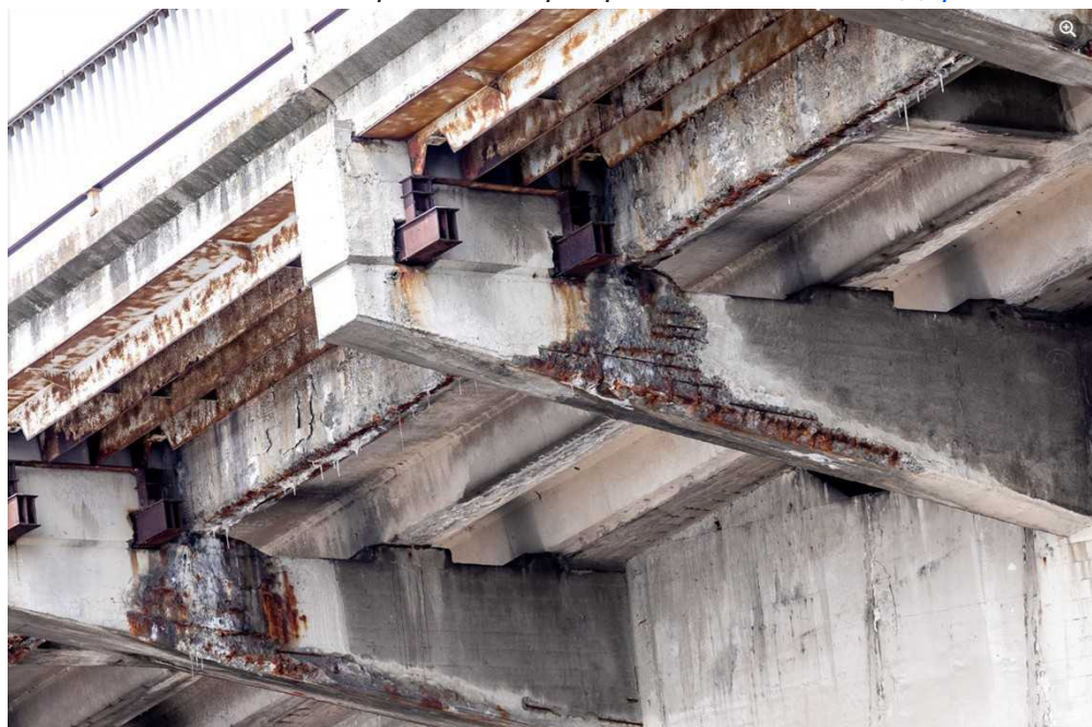
Рис.4. Стан мостів в Україні, які перевіряла комісія. Фото Держвідновлення , 2023.
