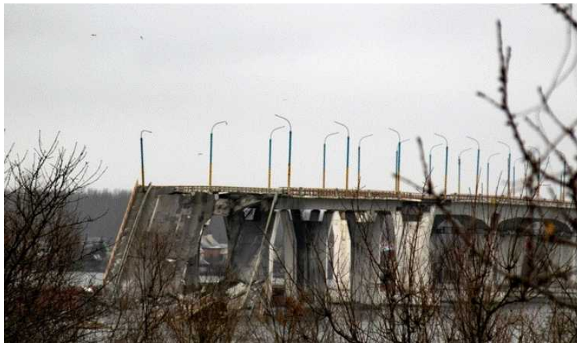
Рис.9. Зруйнований воєнними діями Антонівський міст через Дніпро поблизу м. Херсона
